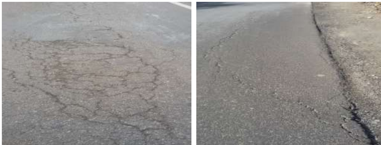
Fig: 6.1- Crocodile cracks
